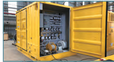
발전기부하 시험 장비 Generator load test equipment
